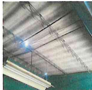
Foto 2: Lamina en mal estado en la dirección
