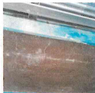
Foto 4: Terraza en mal estado por filtración de agua
