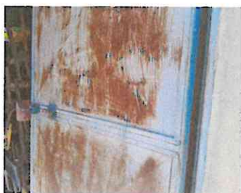
Foto 5: Puerta en mal estado.
